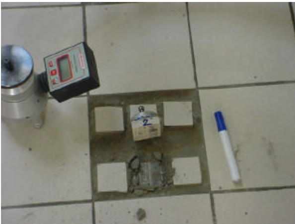
Adherència de paviment de gres
