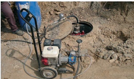
Prova de resistència i estanquitat de canonades en xarxa d'abastament d'aigua d'una urbanització.
