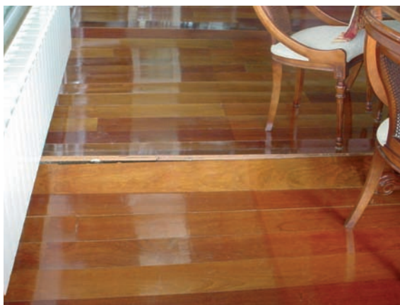
Valoració de danys en un habitatge afectat per inundacions.
