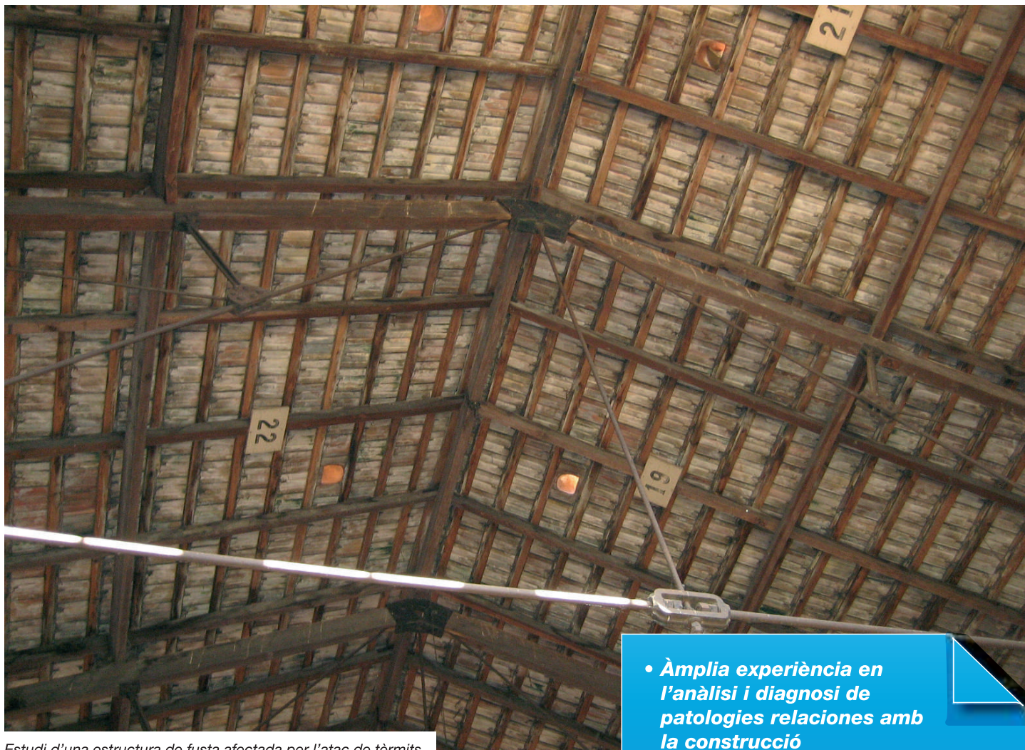
Estudi d'una estructura de fusta afectada per l'atac de tèrmits.
