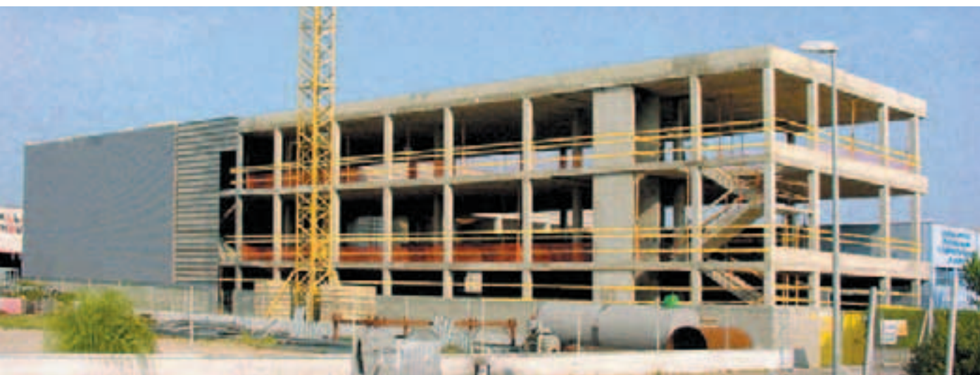
Procés de construcció de l'edifici de tres plantes, annex a les instal·lacions actuals.
