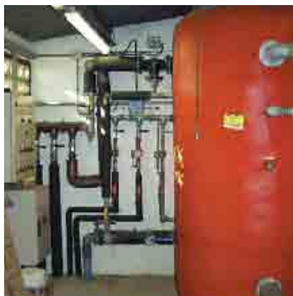
Instal·lació de risc de Legionel·la - PCC
