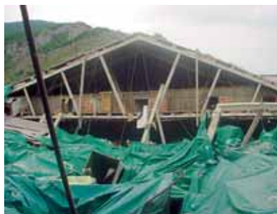
ESFONDRAMENT D'UNA NAU INDUSTRIAL.
