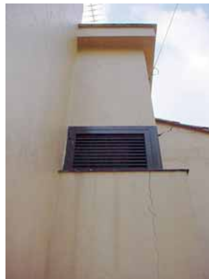
FISSURES EN UN HABITATGE UNIFAMILIAR AÏLLAT CAUSADES PER ASSENTAMENTS DEL TERRENY.
