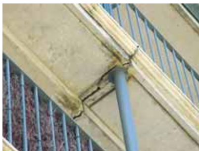
FISSURA EN LA JUNTA DE DILATACIÓ D'UN EDIFICI PLURIFAMILIAR.
